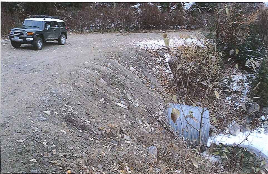
CK2205 Outlet fill erosion
